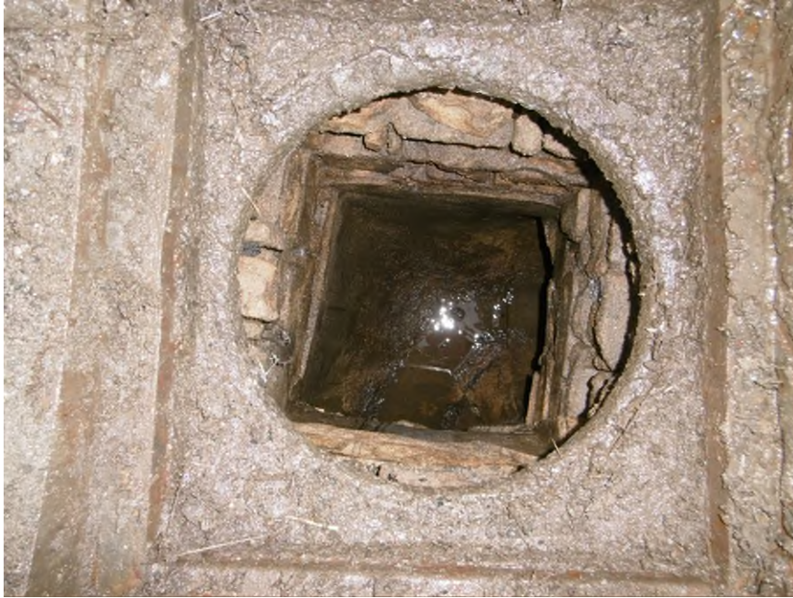
Abbildung 3.1.2: Sanierungsbedürftiger Schacht 30011104A in Bruchsteinmauerwerk erstellt.
