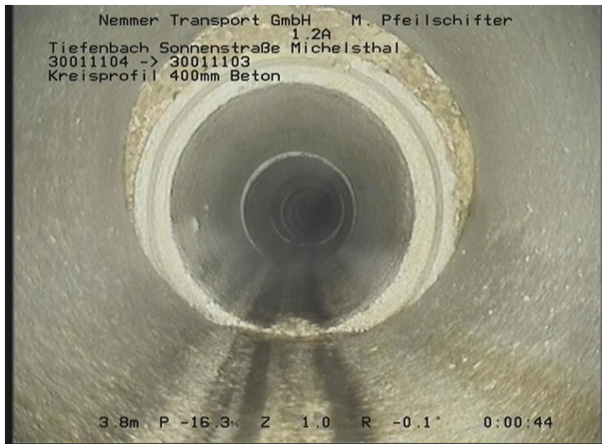
Abbildung 3.1.3: Fehlerhafter Anschluss des Ableitungskanals; Rohrprofilreduzierung von DN400 auf DN300.
